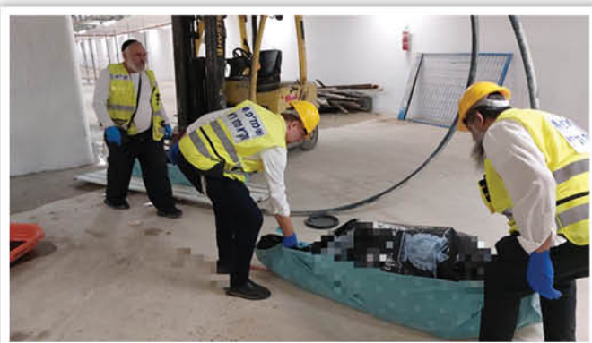
תאונת עבודה: שני פועלים זרים נפלו אל מותם בפיר באתר בניה בבת ים. מתנדבי זק"א חילצו את הגופות יחד עם כוחות כיבוי אש. לאחר מכן הועברו למכון הלאומי לרפואה משפטית
